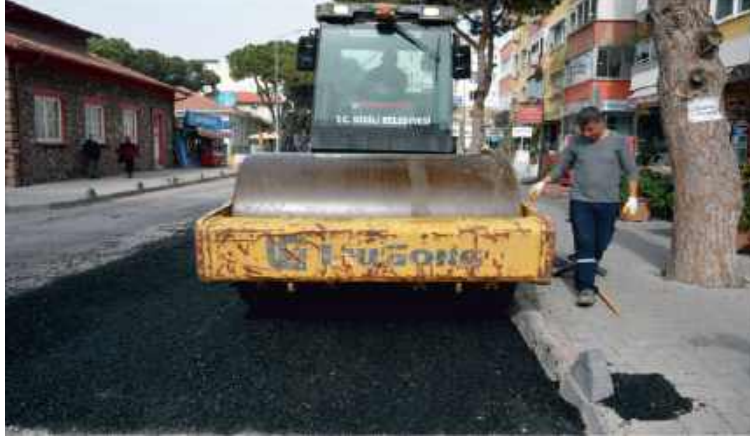
100-İsmetpaşa Mahallesi Şehit Sami Akbulut Caddesi 1 Nolu Sağlık Ocağı Çevre Düzenlemesi ve Kaldırım Yapım İşi
